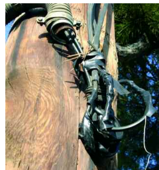
Detalle de empalme de cables de líneas telefónicas
