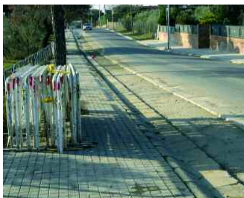
Vallas descansando mientras esta la zanja sin proteger
