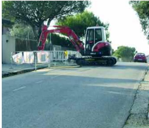
Máquina trabajando cruzada en la calle sin nada que lo avise en cambio de rasante
